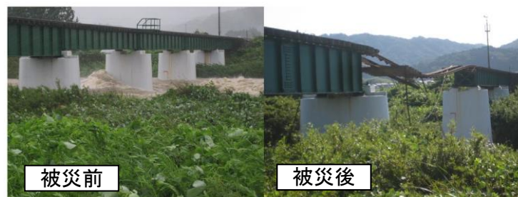
杣川・信楽高原鐵道杣川橋梁流失 (平成25年9月洪水)
