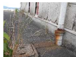
外壁パネルの破損
