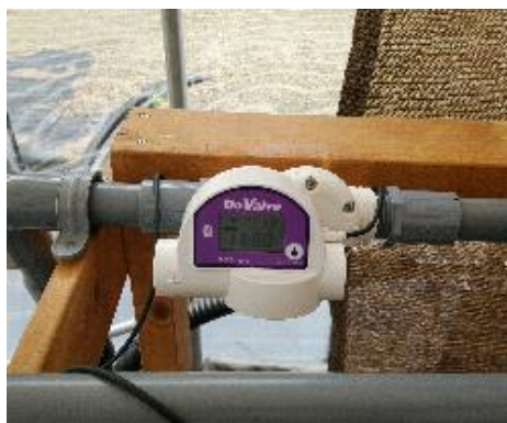
ICTバルブの設置状況
