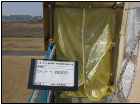
クリーンルーム
