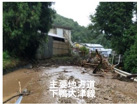
図 令和3年8月の大雨による道路被害状況
