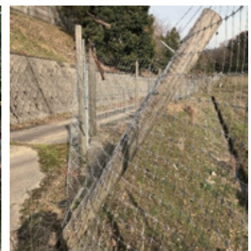
修繕が必要な侵入防止柵
