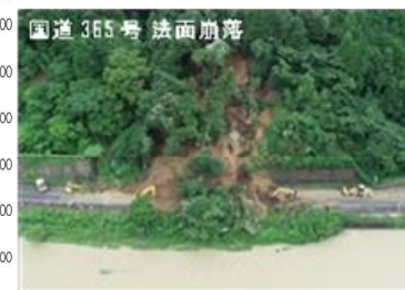
図 台風等による被害状況
