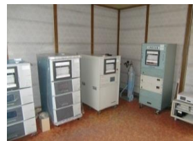
大気自動測定局の内部
