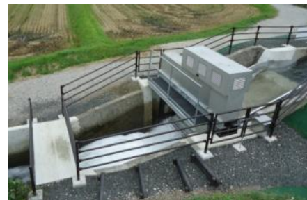
農業用水路の落差を利用した小水力発電 (米原市姉川沿岸土地改良区)
