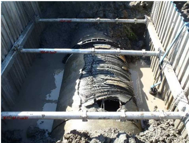
管水路の破損事故
