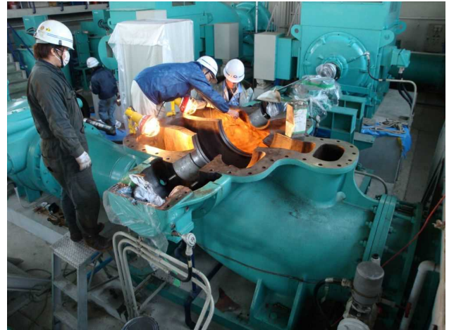
ポンプの点検
