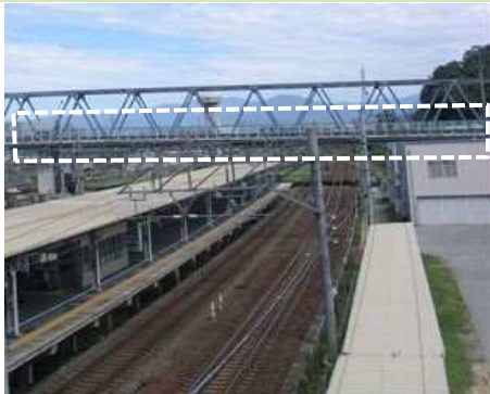
橋梁の損傷事例(米原こ線橋)
