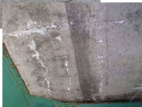
路面下状況 (遊離石灰有り)
