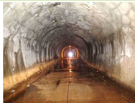
トンネルの損傷事例(賤ヶ岳隧道)
