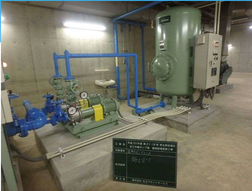
洗浄水ユニット 更新
