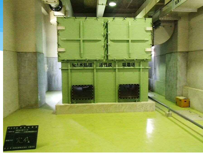
水処理脱臭機械 更新
