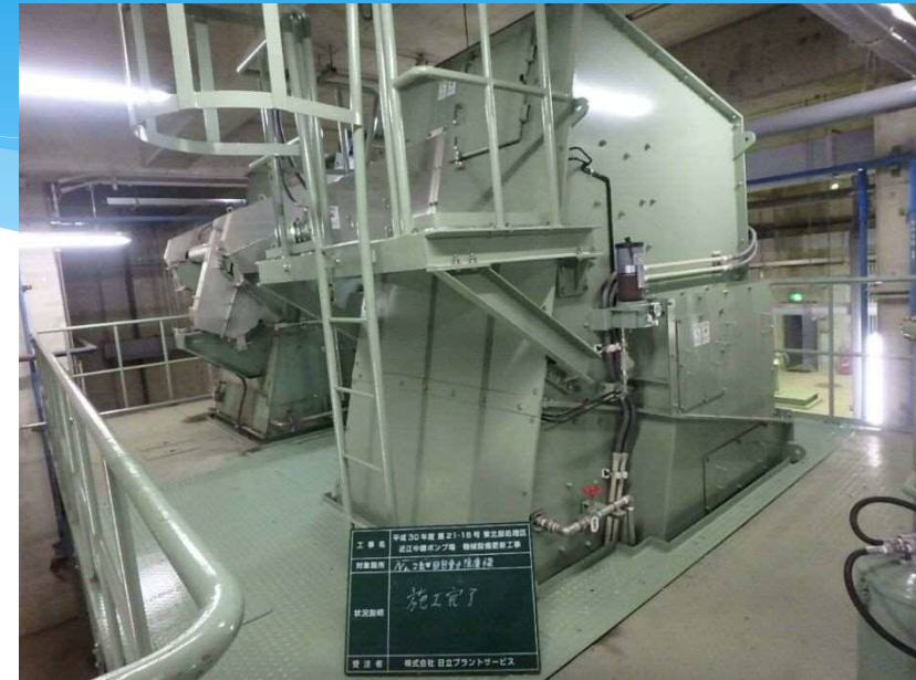
No2細目自動除塵機 更新
