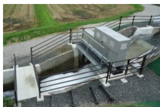
農業用水路の落差を利用した小水力発電 （米原市姉川沿岸土地改良区）
