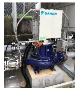
管水路用マイクロ水力発電システム （近江八幡市長福寺町）
