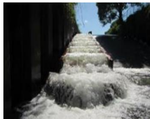
落差工に設置した魚道
