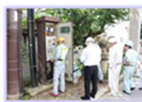
マンホールポンプ 停電対応訓練
