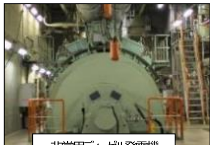
非常用ディーゼル発電機
