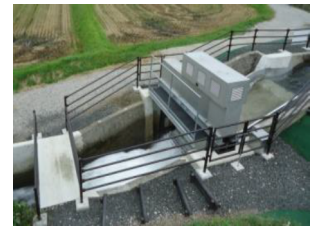
農業用水路の落差を利用した小水力発電（米原市姉川沿岸土地改良区）
