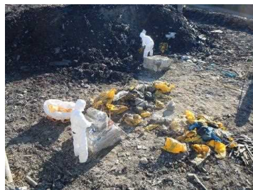
平成29年11月1日 廃石綿等(固結物)
