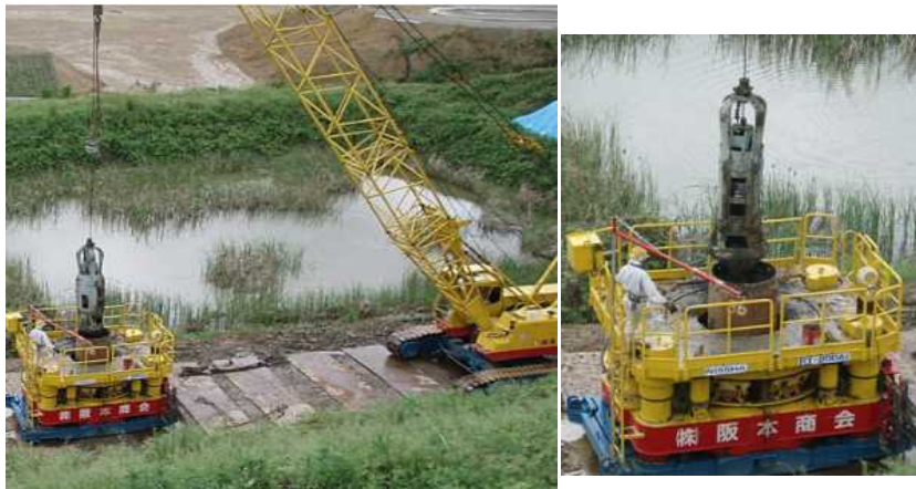
オールケーシング工法 施工写真(B工区No.5揚水井戸設置時)
