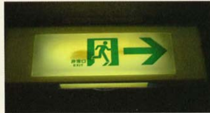
劣化した表示板の例
