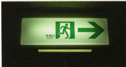
正常な表示板
