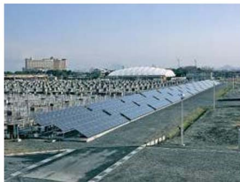
図 3-3-25. 湖南中部浄化センターにおける太陽光発電
