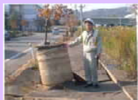
(地震によるマンホール浮上)
