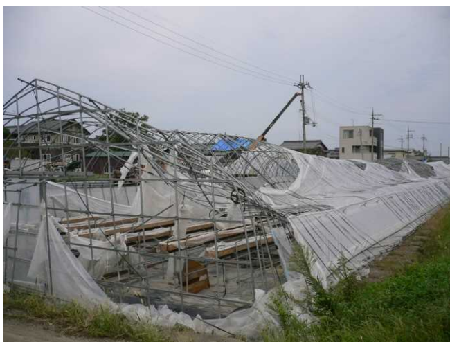
台風 21 号で押し潰された管内の パイプハウス
