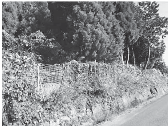
土砂が押し寄せ、クズに覆われた状態の柵
