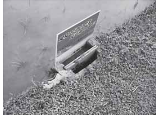
排水口に設置された止水板
