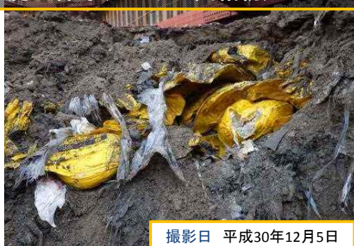
廃石綿等(モルタル固結物)
