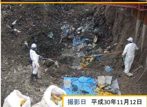
廃石綿等(モルタル固結物)
