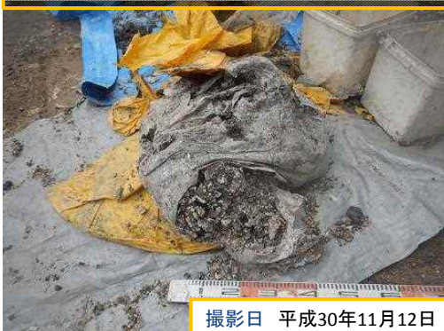
廃石綿等(モルタル固結物)
