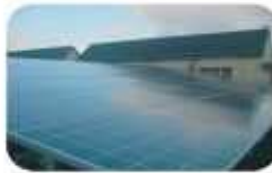
ソーラー発電 (10KW×4基)
