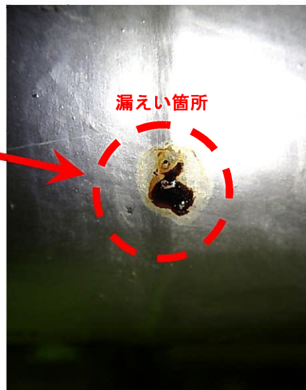
【高電導度ドレン系配管拡大写真】
