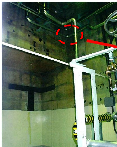
【高電導度ドレン系配管漏えい箇所】
