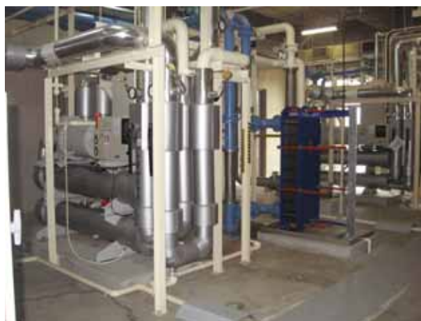
下水熱を利用した冷暖房システム
