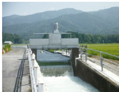
農業用水路の落差を利用した小水力発電 （長浜市 湖北土地改良区）
