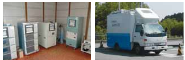
測定局の内部
