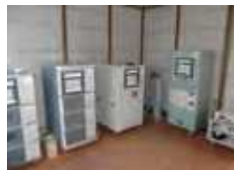
測定局の内部
