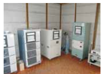
測定局の内部
