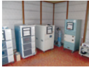
測定局の内部
