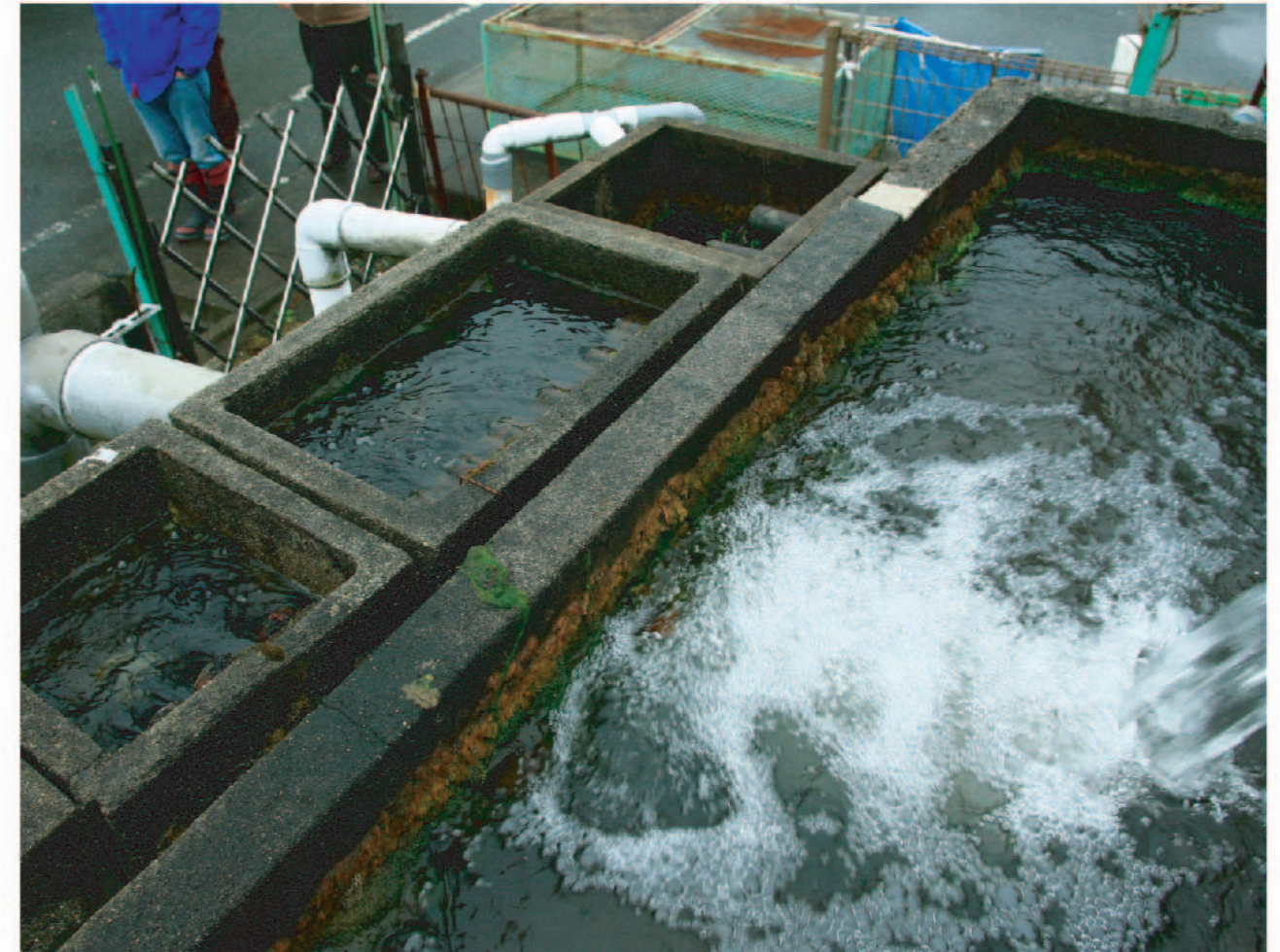
日吉山山水水道「立ち上がり」水槽
