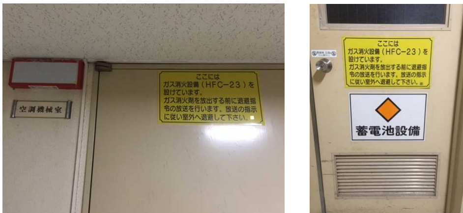
(県庁新館 空調機械室)
