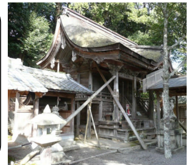
老朽化により傾斜し 支柱で支える建造物
