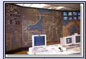
交通管制センター
