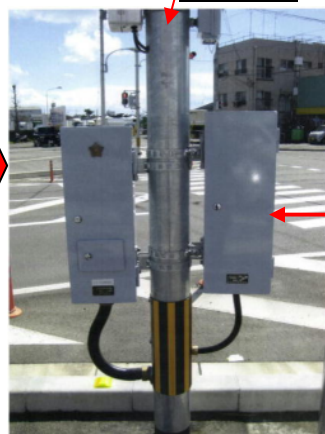
停電後瞬時に起動 震度、風速50mに耐える強度 耐用年数50年
