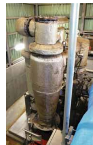
木材チップボイラー
