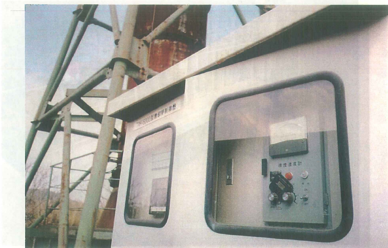
コントロールパネル/扉が開いた状態
