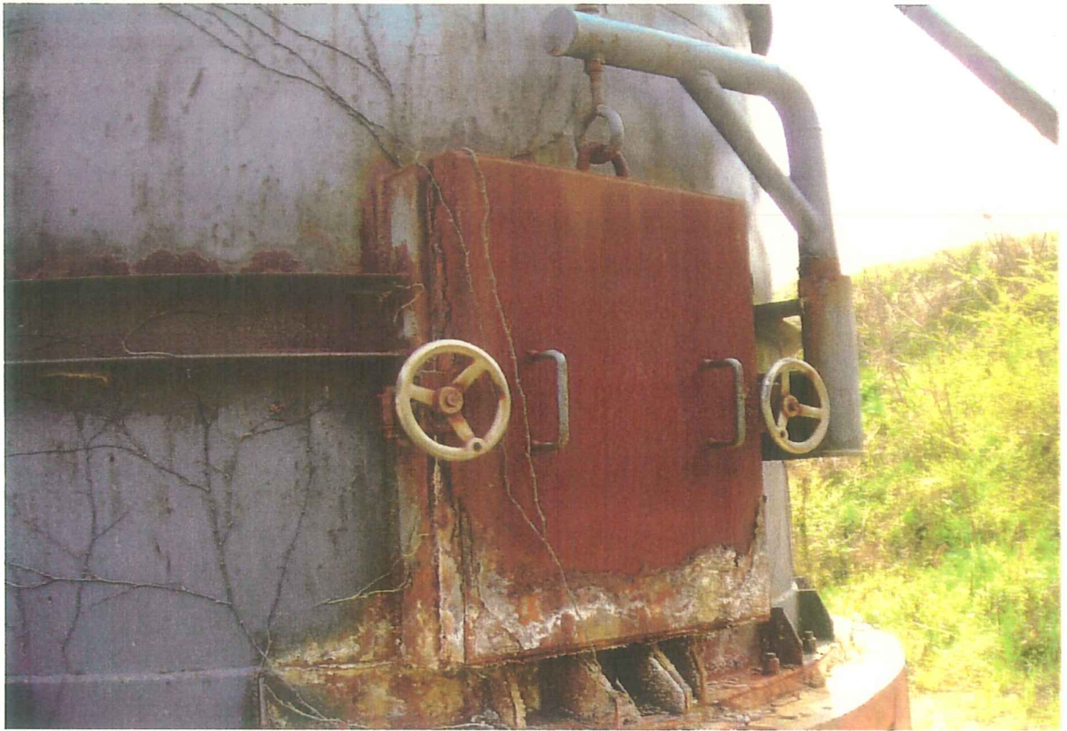
② 煙突下部（点検口） 点検口腐食
