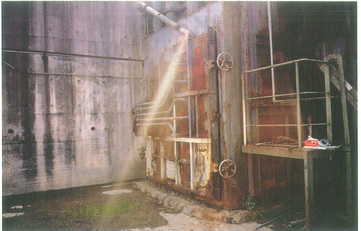
燃烧炉下部（灰出口）
