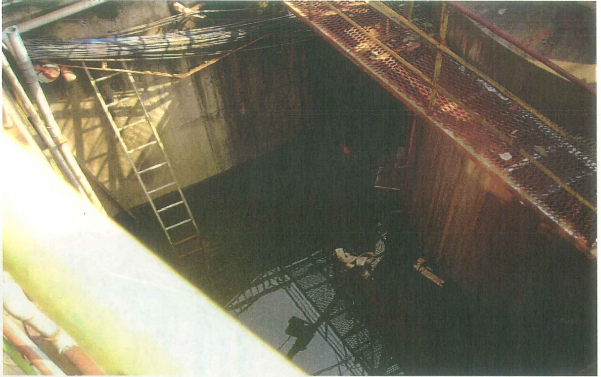
⑦焼却炉乾留炉水没部
