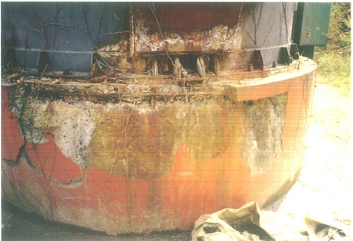
③ 煙突下部（点検口） 基礎部/コンクリート部の劣化状況（鉄筋露出、腐食）
