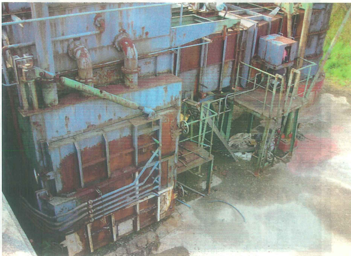
① 燃焼炉下部 (灰出口)
