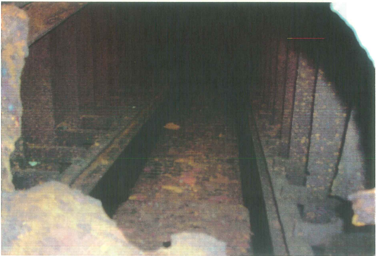
③ 集塵機上部 (内部)
