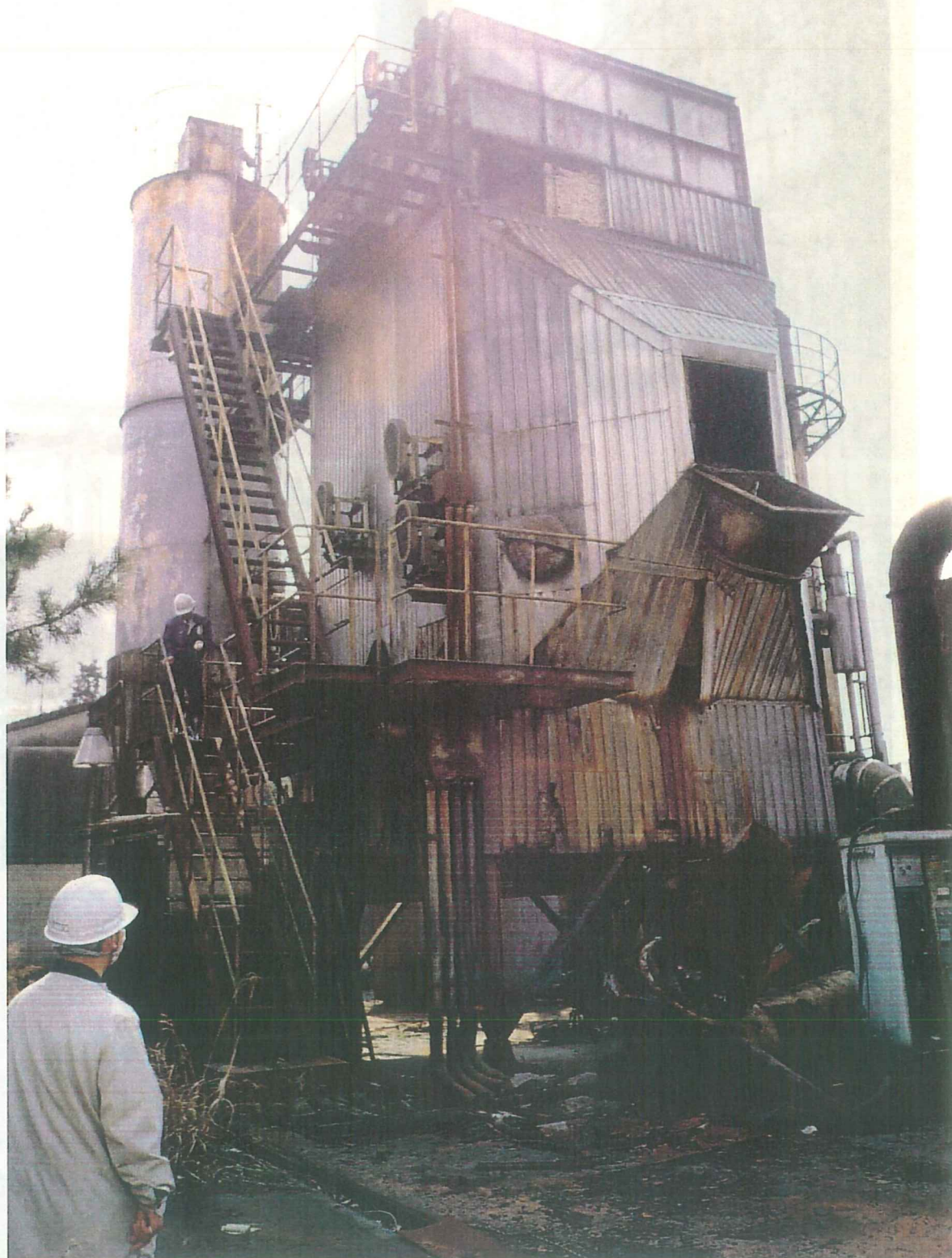
集塵機と煙突の接合部の脱落状況
