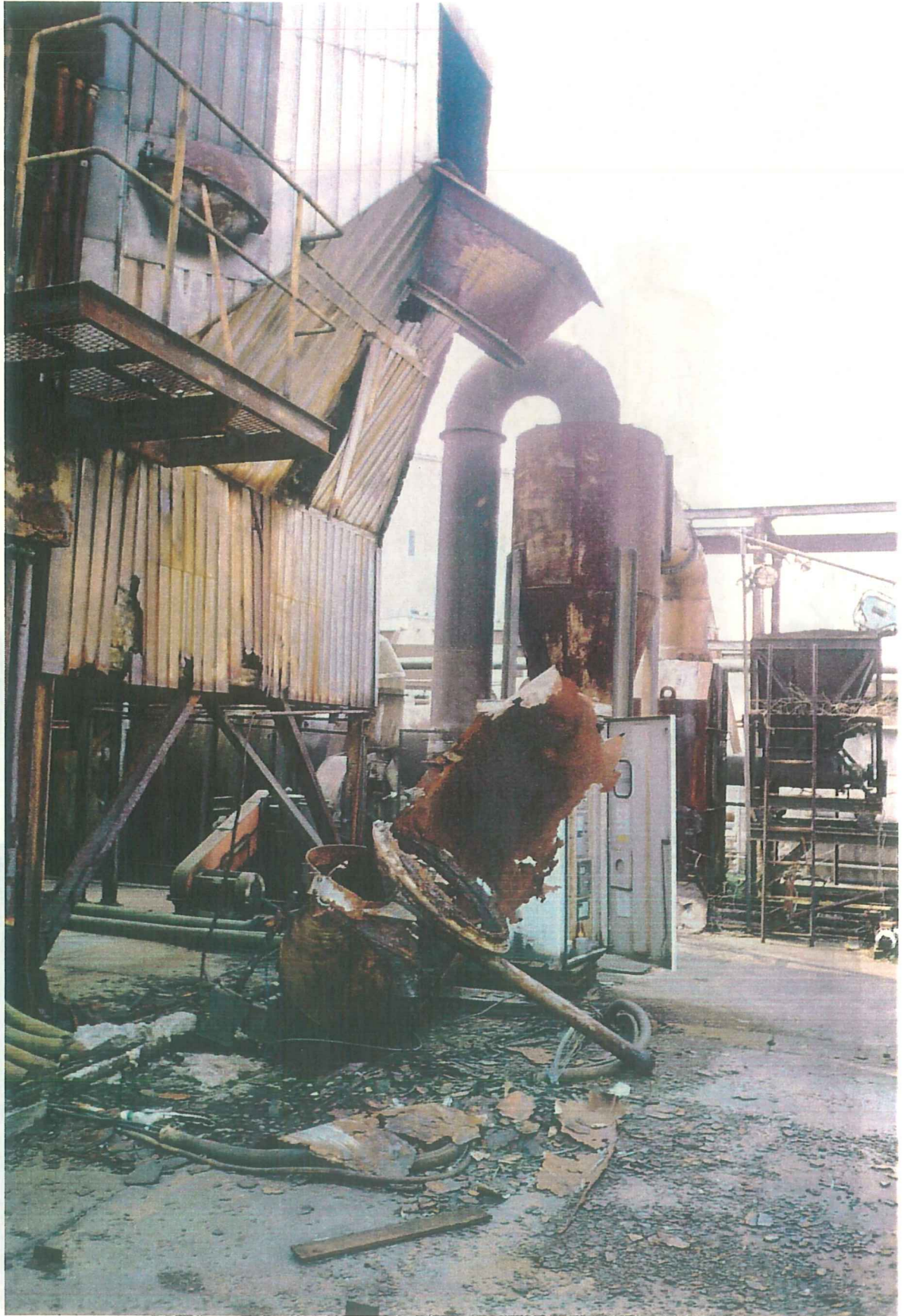
集塵機と煙突の接合部の脱落状況
