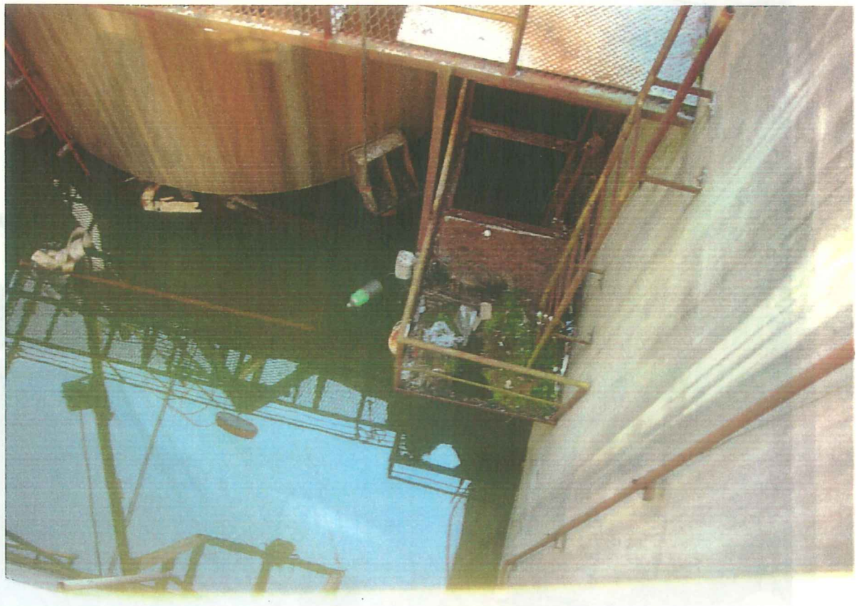
⑥ 焼却炉乾留炉水没部
