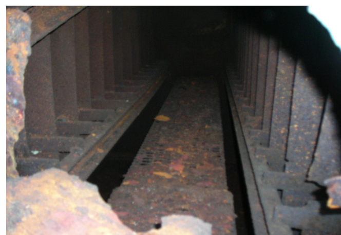
③集塵機上部（内部）
