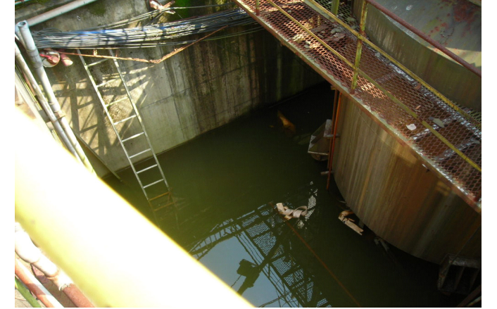
⑦焼却炉乾留炉水没部
