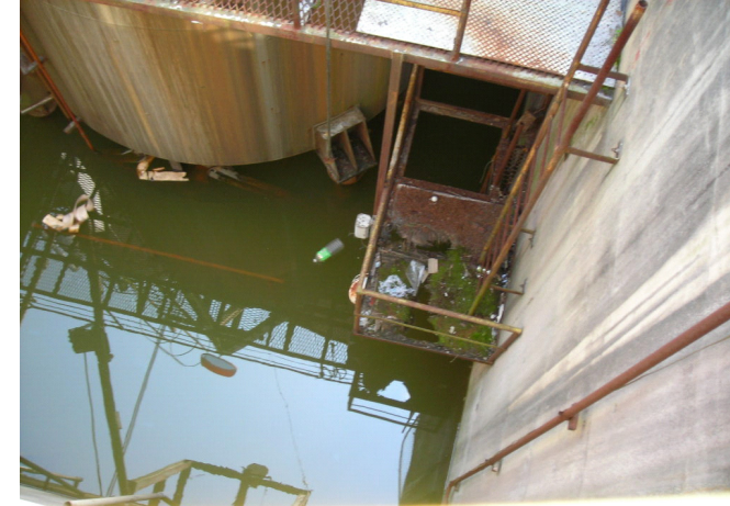
⑥焼却炉乾留炉水没部
