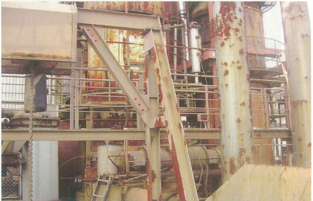
ロータリーキルン/腐食状況
