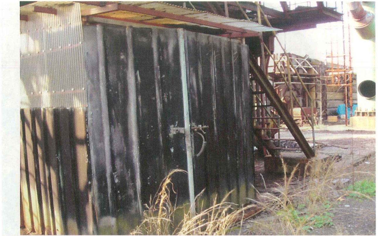
②集塵機下部 (灰出し口)
