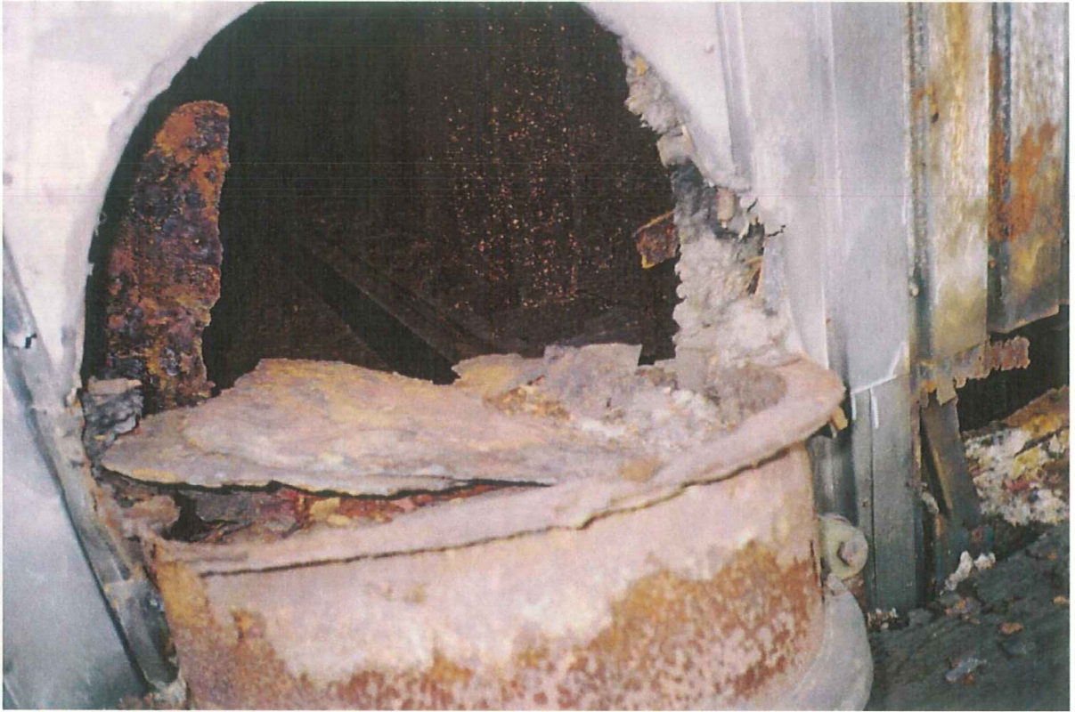
③集塵機上部
