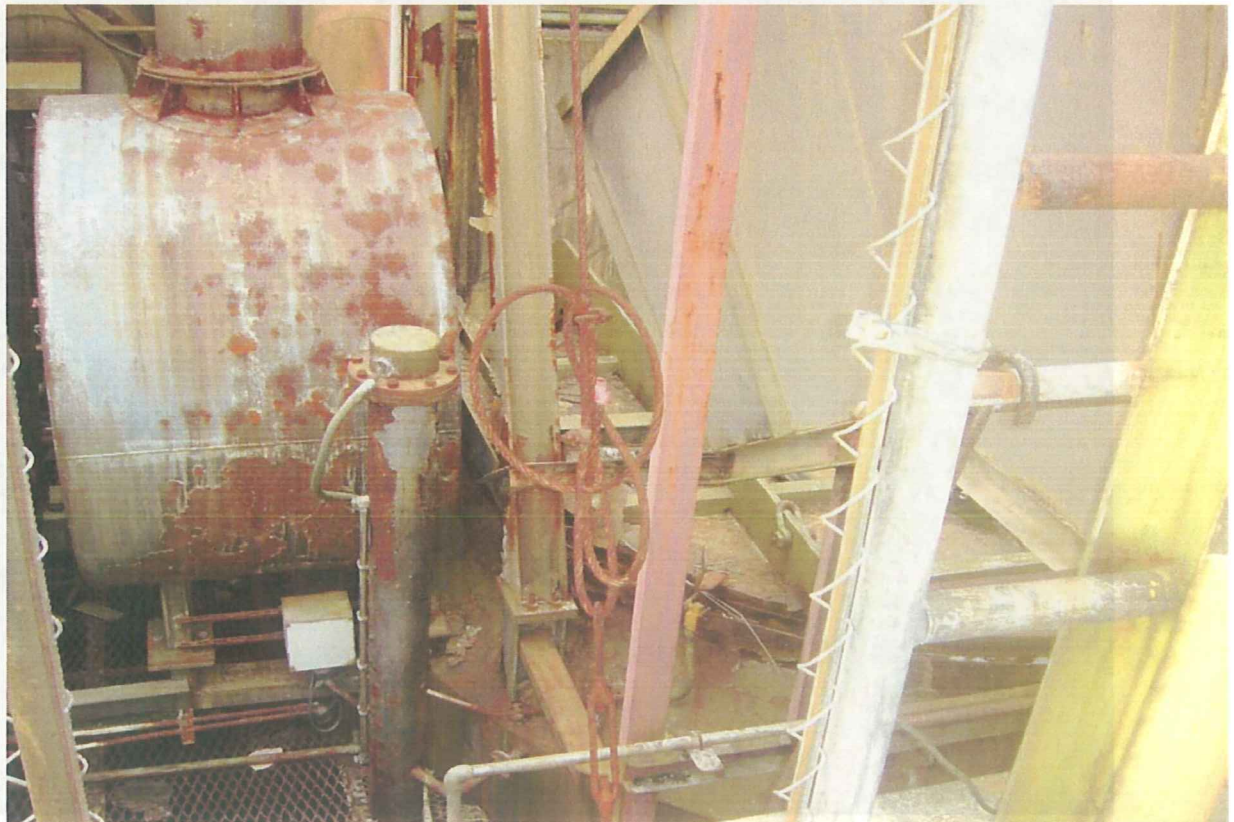
ロータリーキルン/腐食状況
