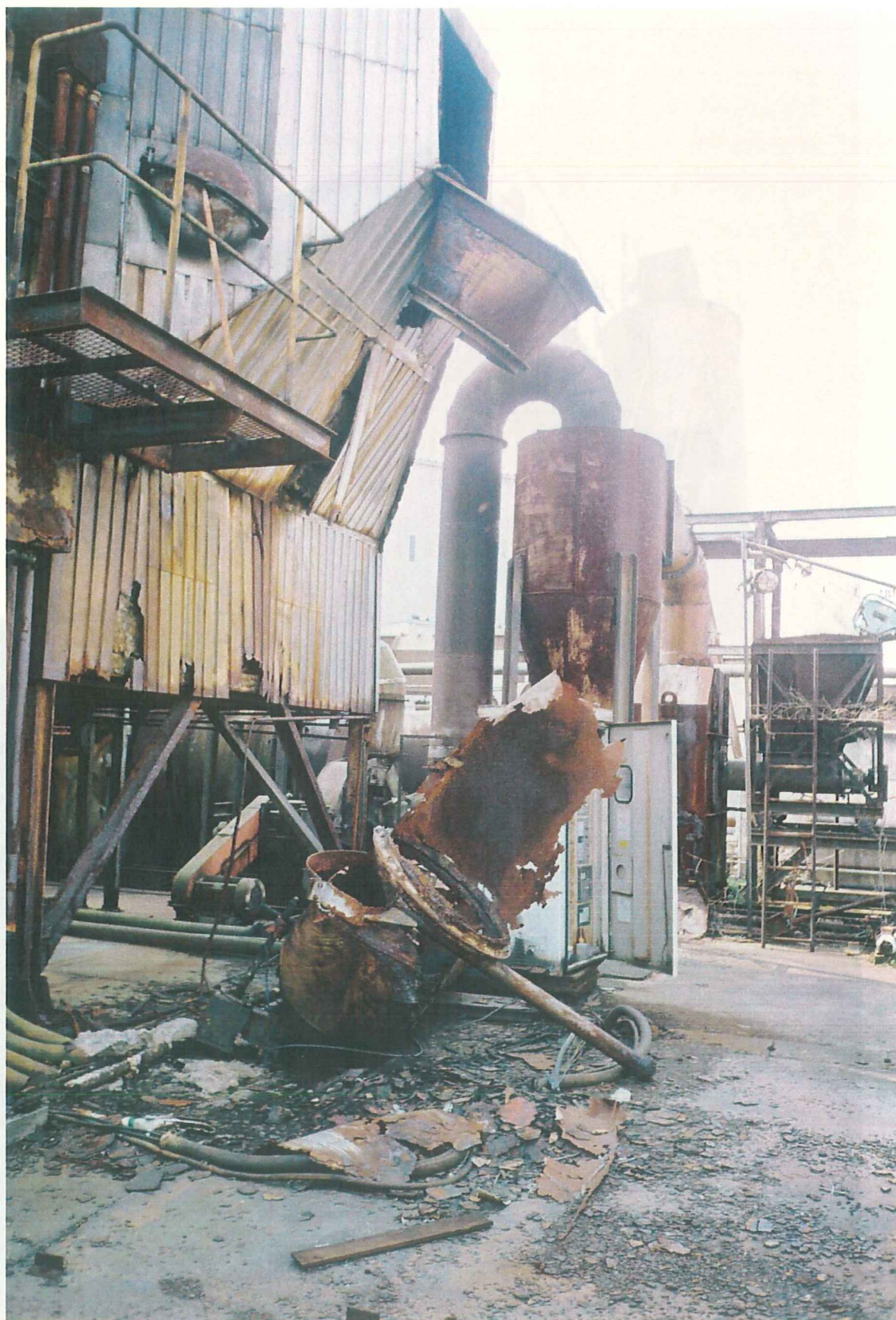
集塵機と煙突の接合部の脱落状況
