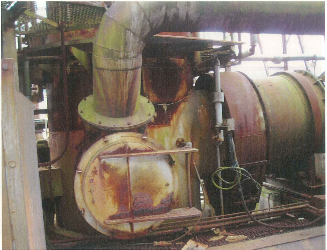
① 冷却塔下部（点検口）
