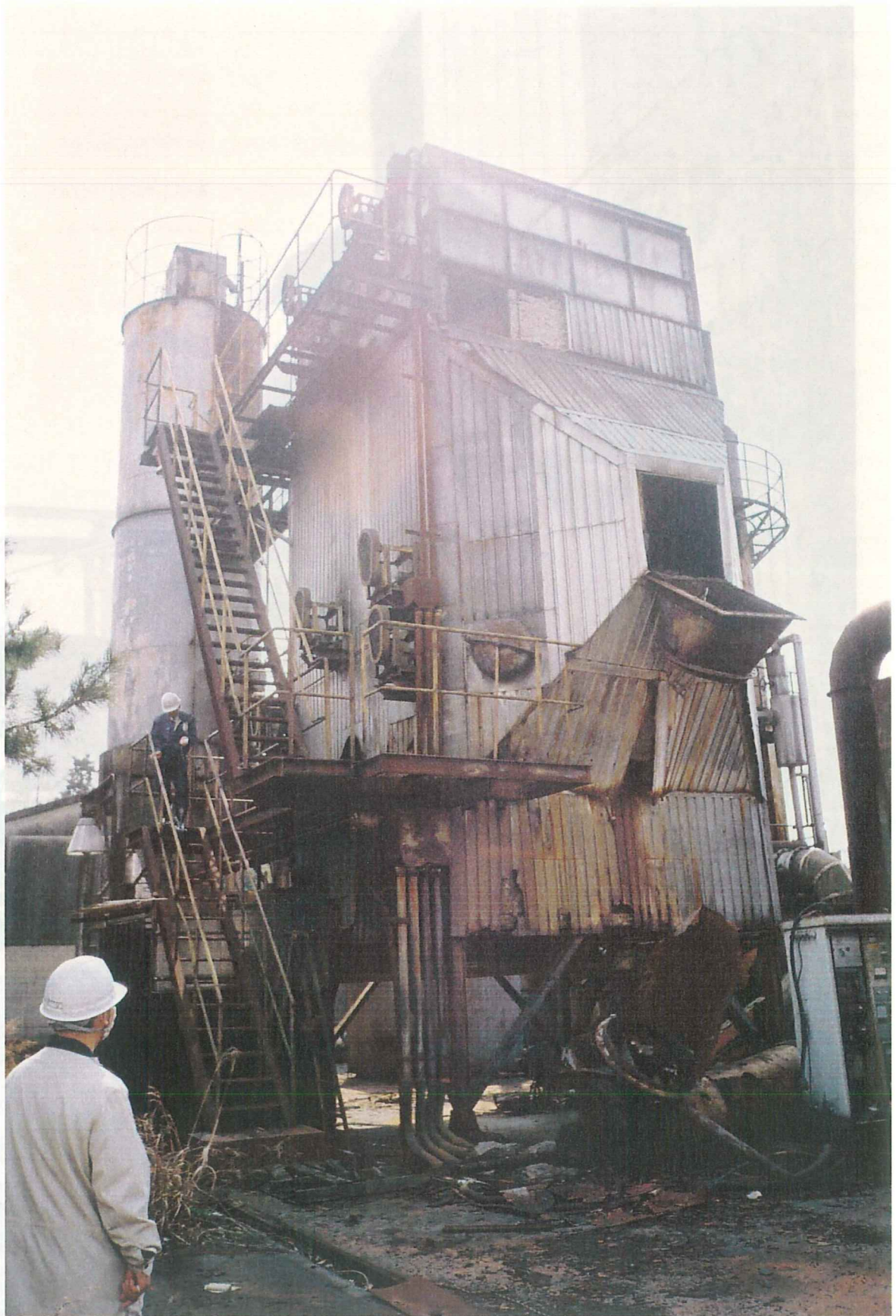
集塵機と煙突の接合部の脱落状況
