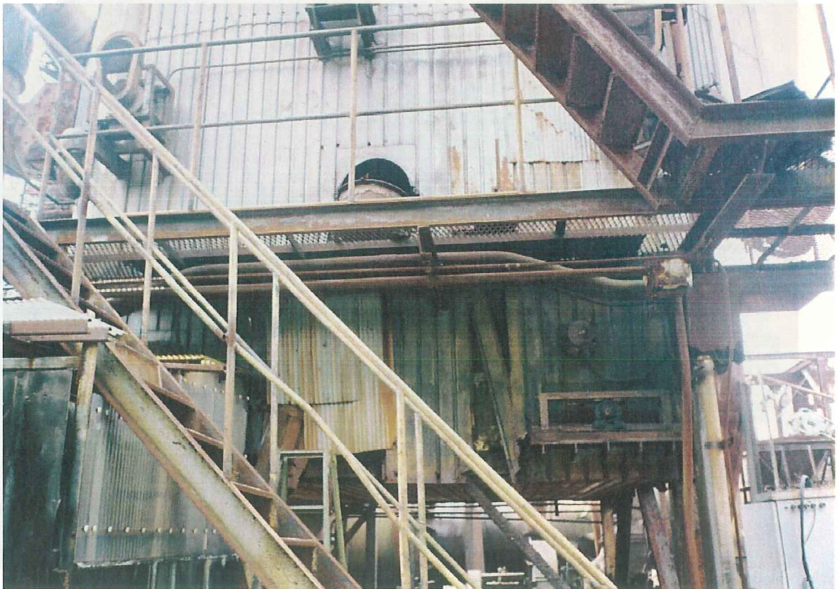
③集塵機上部
