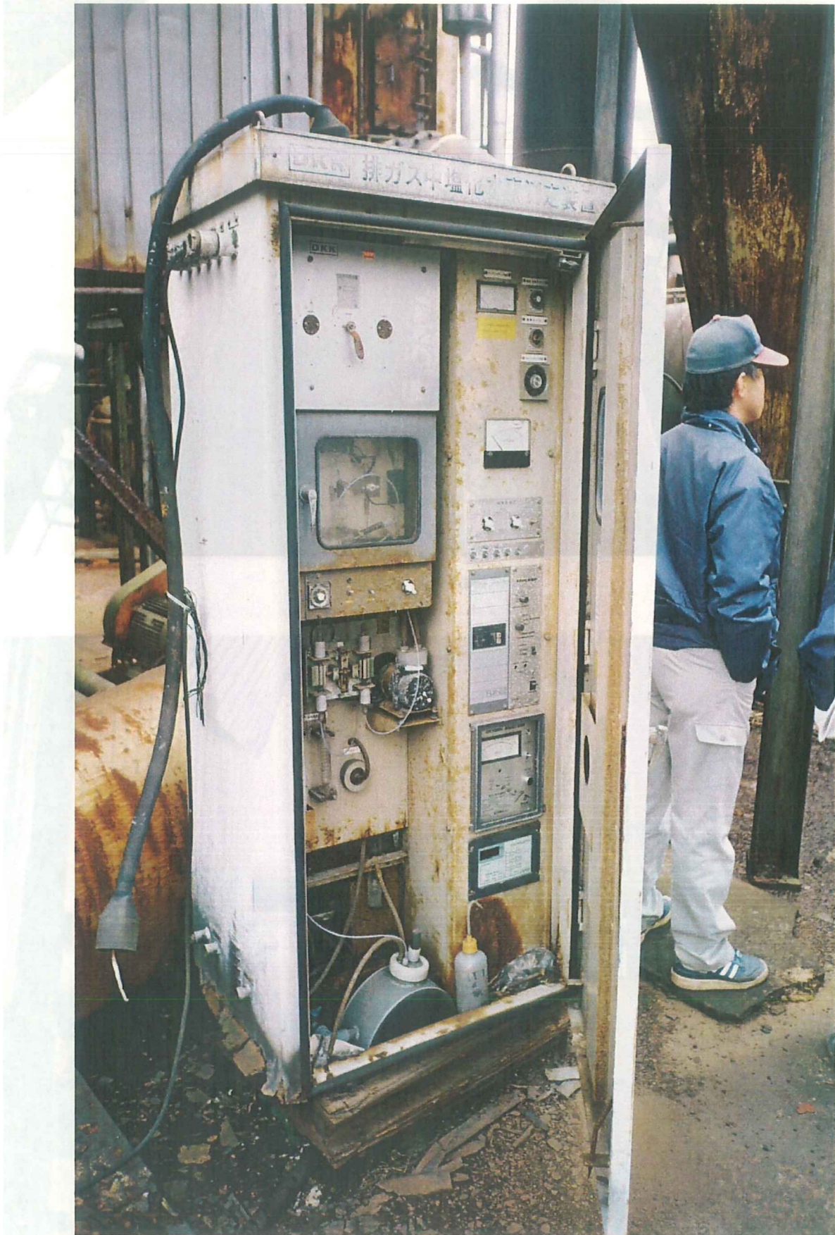
パネルの腐食状況
