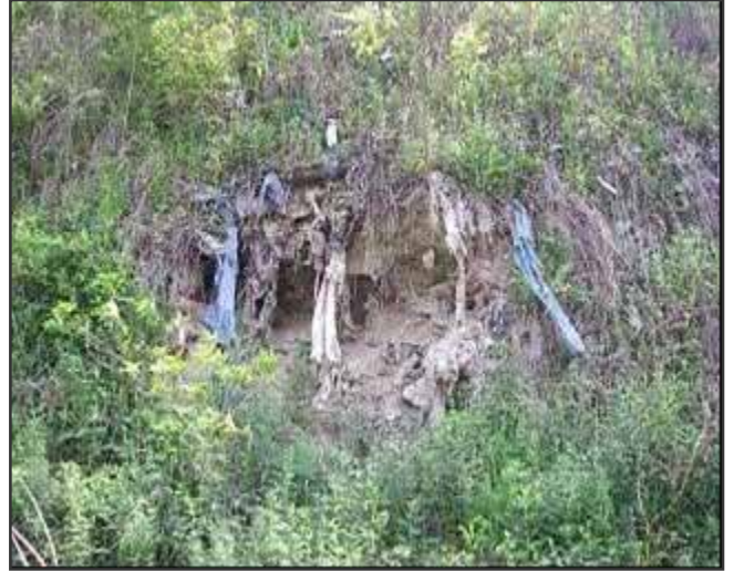
写真 2.2 法面に露出する廃棄物
