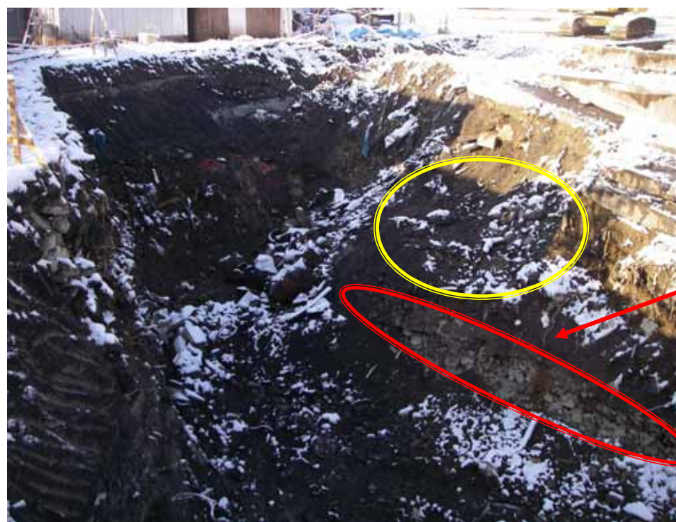
平成 20 年 2 月 15・16 日掘削： -4 ~ 58 スロープ下部 1.0~2.5m 写真 4.18 -4 におけるドラム缶の埋め立て状況
