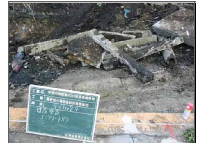
写真4.4 -4 コンクリートガラ
