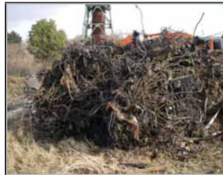
写真3.1 掘り出された鉄筋塊
