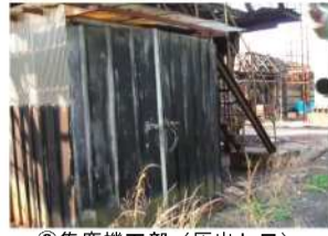
②集塵機下部（灰出し口）
