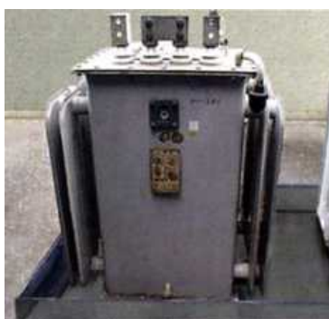
高圧トランス
