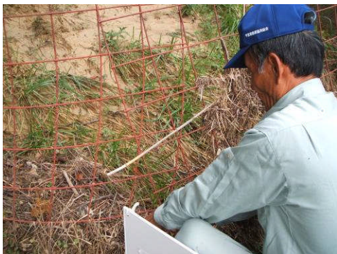
防護柵の破損箇所を確認
