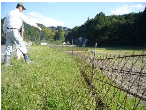
防護柵の倒壊箇所を確認
